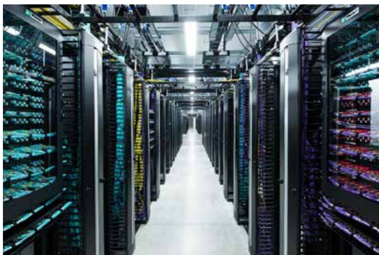
Fig. 1 Ett IT-rum med serverracks. Bildkälla: (FS community 2021)
